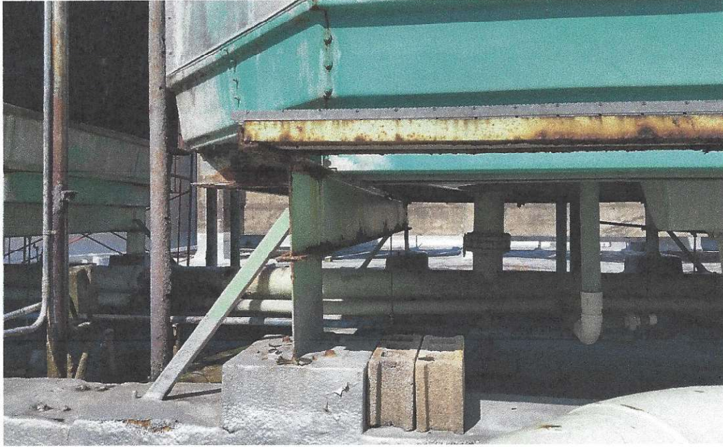
Base de las Torres de Enfriamiento.
