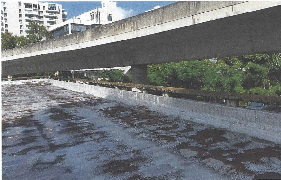
Tope en los parapetos anexos norte y sur. Recomendamos reemplazar.
