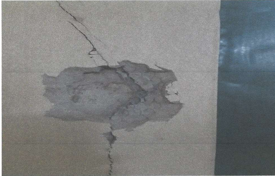
Exploratoria en Columna. (Grieta en el Empañetado no daño estructural.
